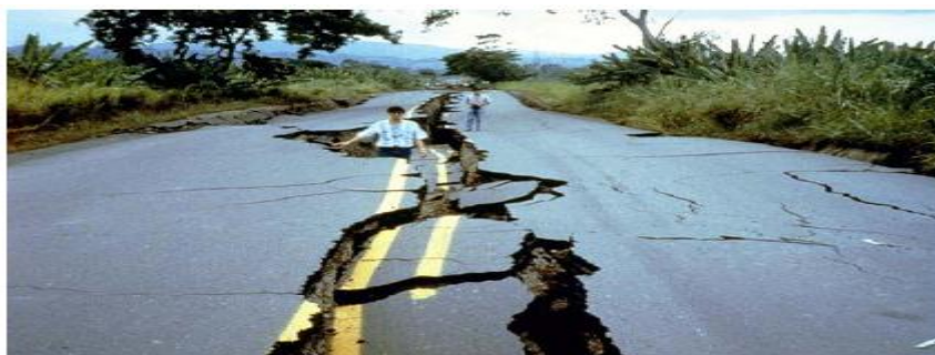
شکل ۱۸- آسیب روسازی راه در زلزله ۱۹۹۱ کاستاریکا [۷]
